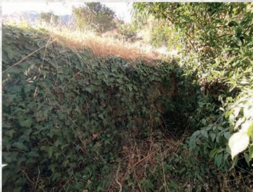
Muro sustentante invadido por hiedra Albánchez de Mágina
