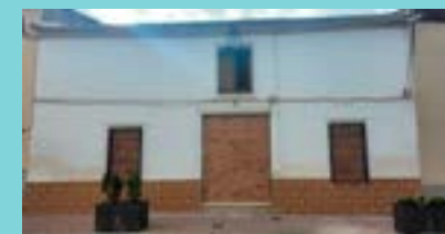
Vivienda 22. Jaén 18: Huecos cegados
